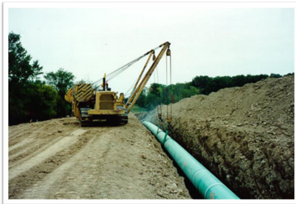
Figura 1.3.1.2.2.-2 Prezentare a modul de lansare a unei conductei de transport gaze naturale în șanț
